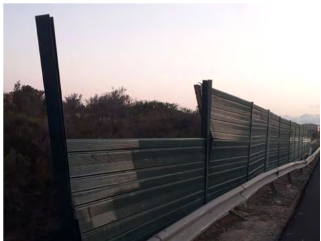
Foto 7. Pantalla dañada debido a espacio insuficiente
