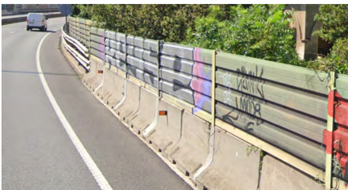
Foto 2. Pantalla sobre barrera de hormigón sin marcado CE
