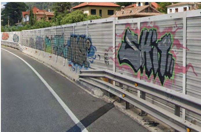
Foto 1. Pantalla sobre barrera de hormigón sin marcado CE
