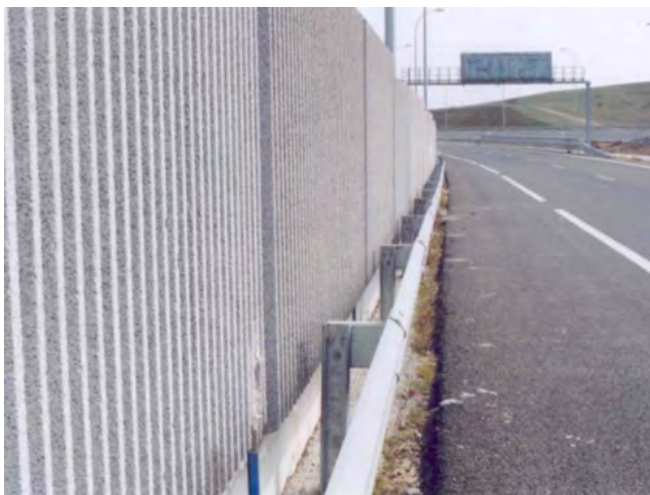
Foto 6. Espacio insuficiente entre barrera y pantalla
