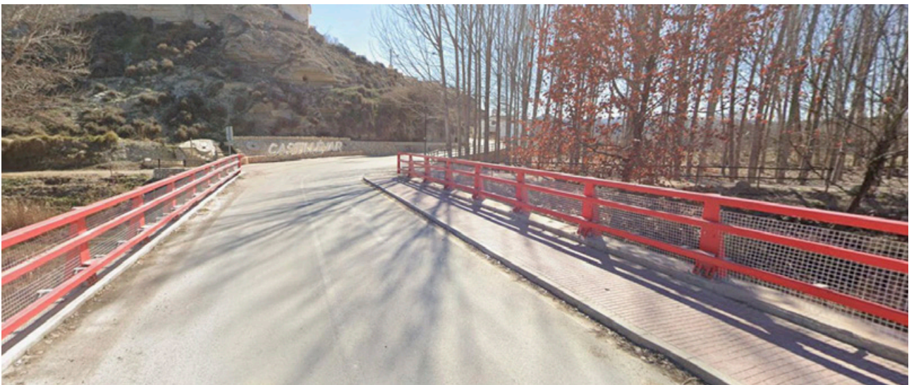
Pretil metálico META13®. Ampliación sobre río Guardal GR-9102. Castillejar, Granada
