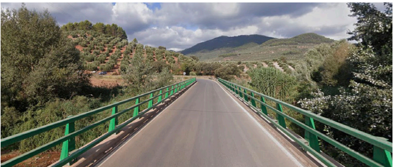
Pretil metálico META13®. Carretera A-317 Puente del Aguadero, travesía Cortijos Nuevos, Jaén
