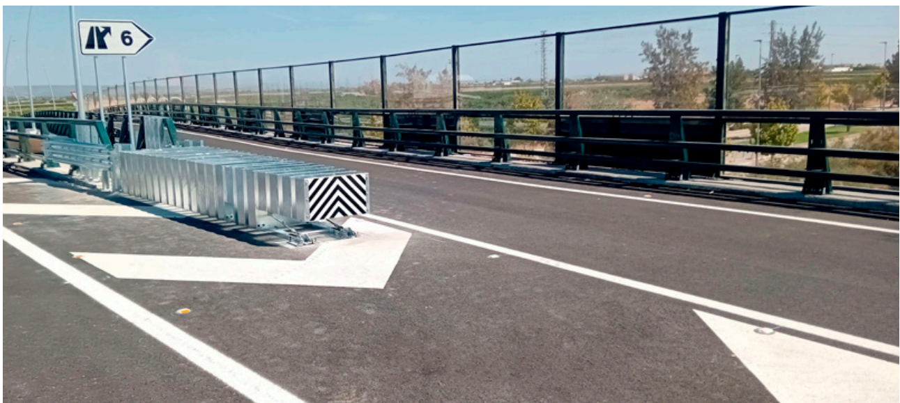
Atenuador de impacto C110 D1600, Pretel metálico META16®. A-8009 de acceso Norte a Sevilla. La Rinconada, Sevilla
