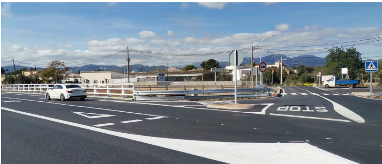
Pretil metálico META13® y barrera metálica. Carretera MA-2031 Vella de Bunyola, a la altura de Torrent Gros, Palma de Mallorca.
